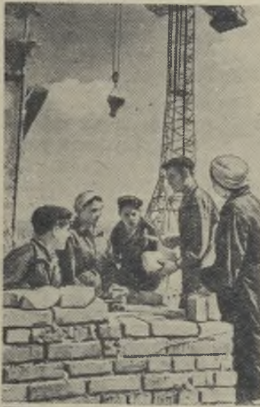
Иркутская область. Широко развернулось строительство Иркутского алюминиевого завода. На стройку шестой пятилетки прибыло 600 юношей и девушек из Орла и Орловской области. Молодые патриоты сооружают завод железобетонных конструкций, ремонтно-механический и арматурный цехи, котельную.
