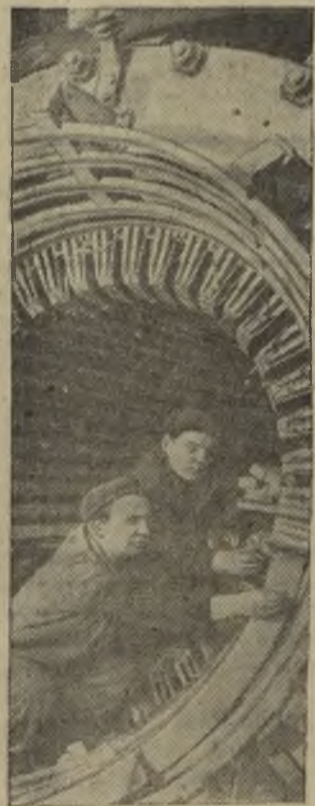
На ленинградской фирме «Электросила» подходят к концу работы по изготовлению турбогенератора-исполнения мощностью в один миллион киловатт. Нигде в мире такой машины нет. На снимке: обмотчики С. Фоменко (слева) и В. Андреев укладывают обмотку в статор. Фото И. БАРАНОВА. Фотохроника ТАСС.
