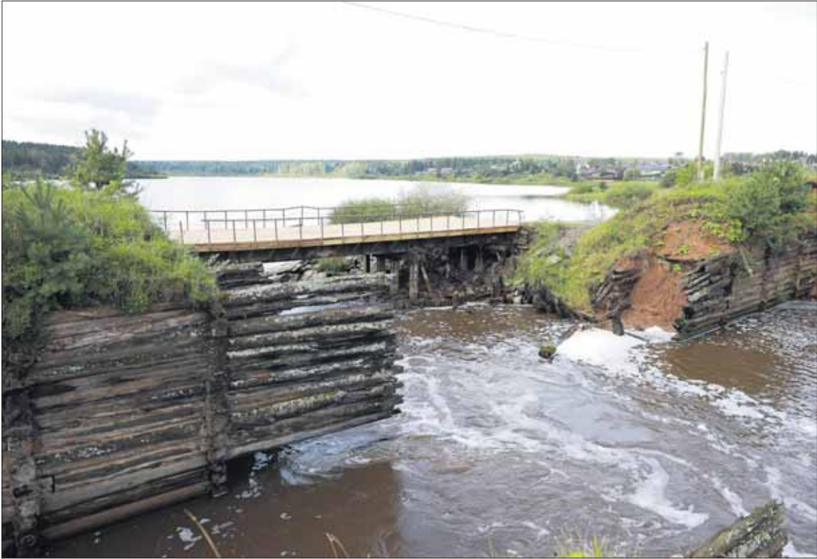
Большая часть плотины либо сломана, либо покрыта мхами и грибком.
