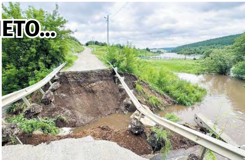
▲ Разрушенный участок дороги в с. Арамашево
