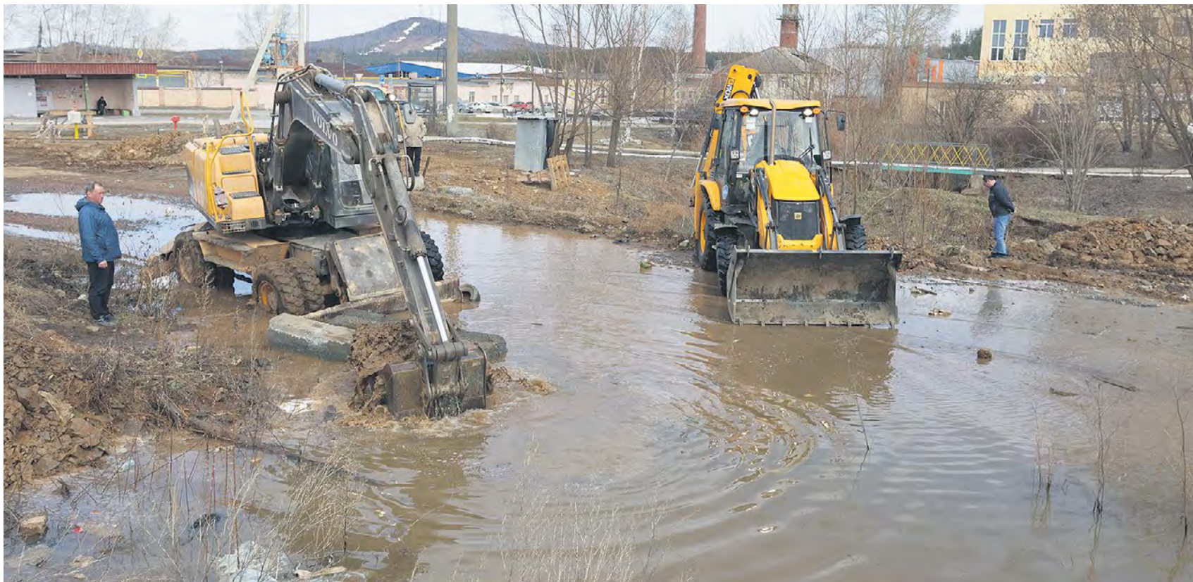
Вот таким после работ ЕТК стал микрорайон Кирзавода — перекопанным, грязным и абсолютно неблагоустроенным. Руководство ЕТК говорит, что земляные работы еще не окончены. // Фото из архива редакции
