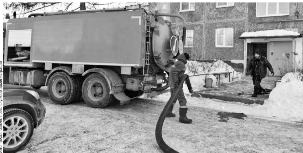
Адреса для промывки «Водоканал» определяет совместно с управляющими компаниями
