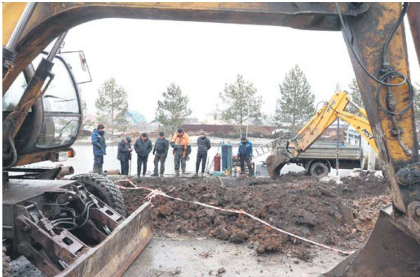
Это улица Павла Зыкина, где «Водоканал» начал замену водопровода в рамках капитального ремонта. // Фото Владимира Коцюбы-Белых
