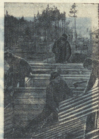
НА СНИМКЕ: бригада Николая Шевченко ведет укладку шифера на крыше дома № 2. Слева направо: Александр Екимов, Борис Муравьев, Алексей Татаринов и Николай Лавров.
