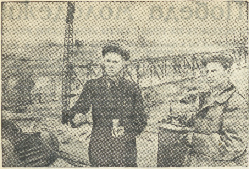
Строители Каховского гидроузла сооружают бетоноукладочный мост, который даст возможность в несколько раз ускорить процесс работ в котловане шлюза.
