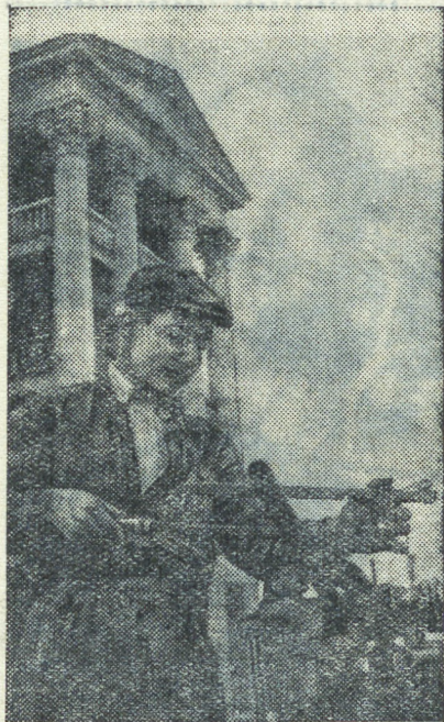
Слесарь-сантехник Анатолий Копосов работает на строительстве нового сорокаквартирного дома по улице Ленина, 56-а, в Свердловске. В честь 33-й годовщины Октября он выполняет свои задания на 150—170 процентов.
