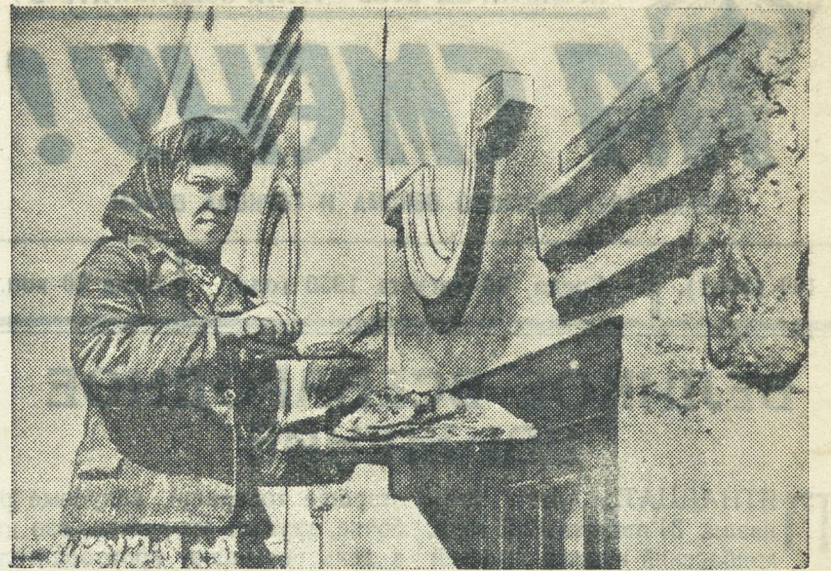
Отлично трудится в дни стахановской вахты мира штукатур Татьяна Никулышина. Работая на наружной отделке школы № 2, строящейся в социалистическом городе Первоуральского новотрубного завода, Татьяна ежедневно выполняет норму на 150—160 процентов.
