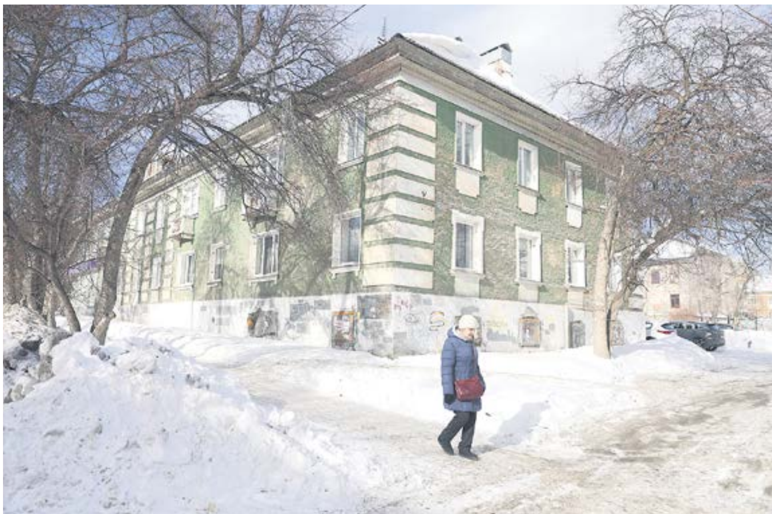
Дом на Чайковского, 19 претендует на звание «аварийный», его жители надеются спасти здание, несмотря на жуткие трещины. // Фото Владимира Коцюбы-Белых
