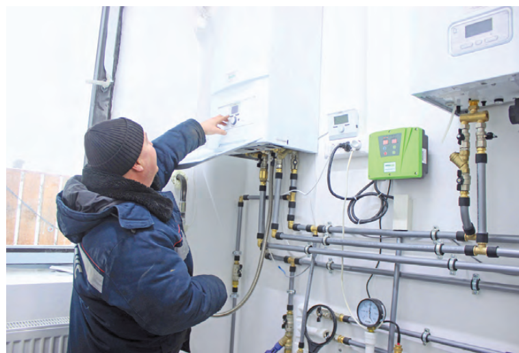
Перед пуском газа специалисты проводят опрессовку и проверяют работоспособность оборудования в частном доме.
