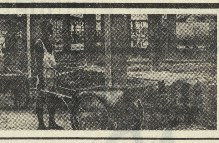
На снимке: занзибарские рабочие на строительстве сахарного завода в городе Мурухуби. Фотохроника ТАСС.
