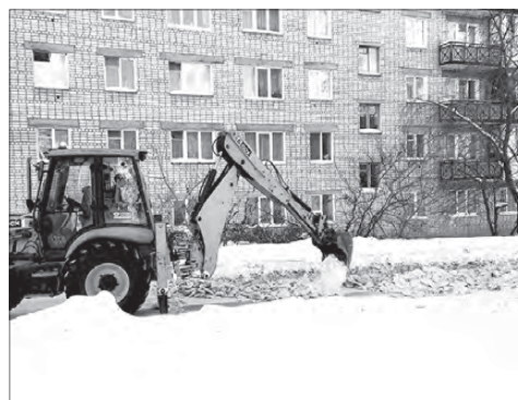
На потенциально аварийных участках дорожные службы в буквальном смысле раскалывают снежный и ледяной покров дороги и очищают до самого асфальта. Снимок сделан на перекрёстке у школы-лицея № 4 «Интеллект»
