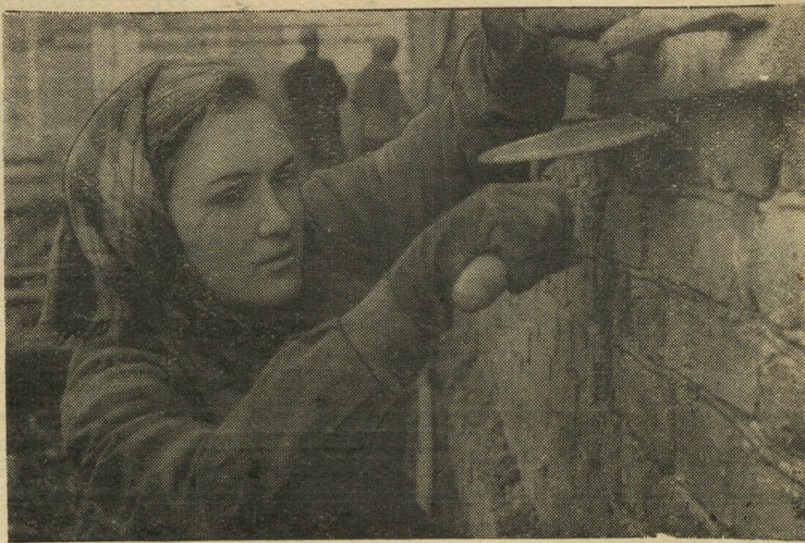
Достоинно несет предпраздничную трудовую вахту молодой штукатур управления № 754 Полина Кузнецова. Она работает в бригаде тов. Чеканиной на строительстве цеха полиэтилена завода «Пластмасс» и систематически перевыполняет сменные нормы выработки.
