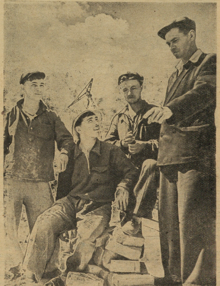
Славными трудовыми делами зарекомендовала себя на строительстве цеха полиэтилена Свердловского завода пластмасс комсомольско-молодежная комплексная бригада Геннадия Степкина. На кладке стен бригада выполняет по полторы нормы.
