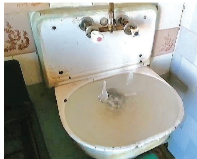
Последствия разморозки квартиры в одном из домов по ул. Сиротина.
