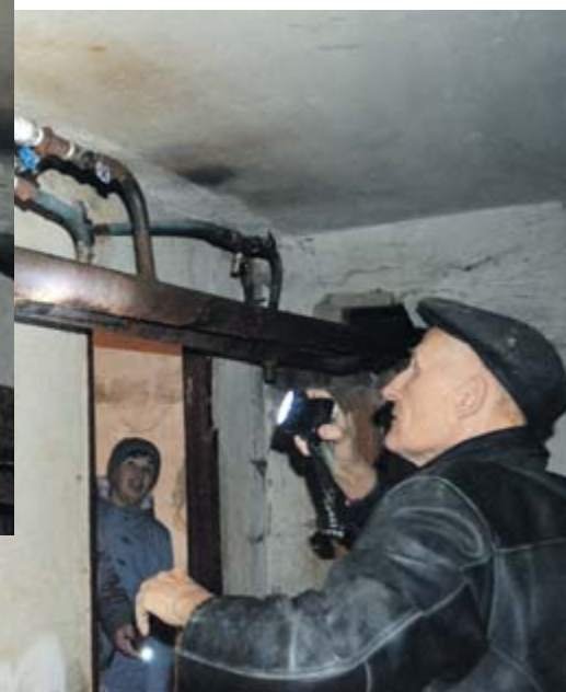
Жители показывают протекающие трубы в подвале
