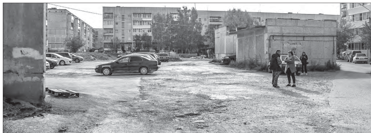
Во Втором микрорайоне проезжая часть во дворе дома № 6 много лет пребывала в таком же состоянии, как дорога к этому дому. Ямочный ремонт не помогает, нужен капитальный
