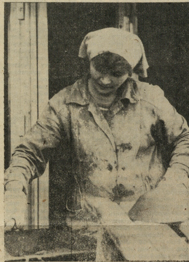
Бригада штукатуров П. Ф. Конева с четвертого участка СУ-7, руководит которым А. А. Копачев, специализируется на отделке объектов соцкультбыта.
