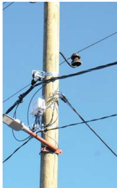
На столбе фонарь уличного освещения и электросчётчик
