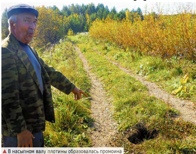
▲ В насыпном валу плотины образовалась промоина
