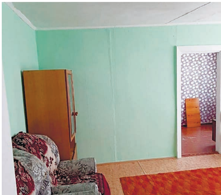
Квартира №7 до обрушения потолка
