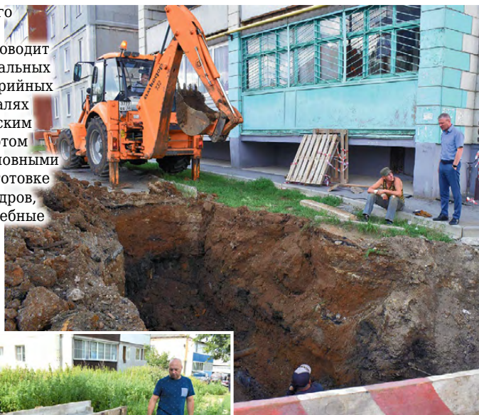
▲ Провал на теплотрассе по ул. Н. Островского, 4
