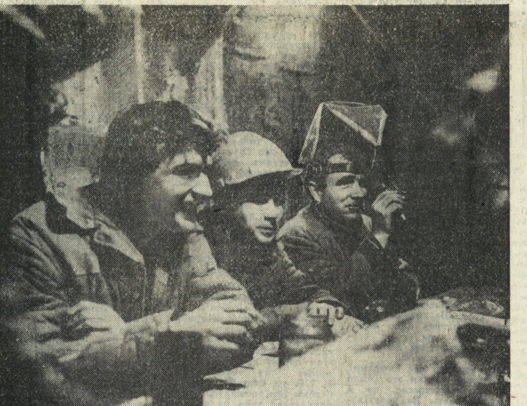
Свердловские метростроители закончили проходку среднего станционного тоннеля на станции «Свердловская». Скоро за работу здесь возьмется отделочники — времени у них осталось немного, пуск намечен на 5 ноября.
