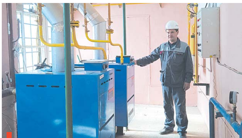
И.о. начальника энергоцеха Андрей Чупин демонстрирует одну из котельных после ремонта
