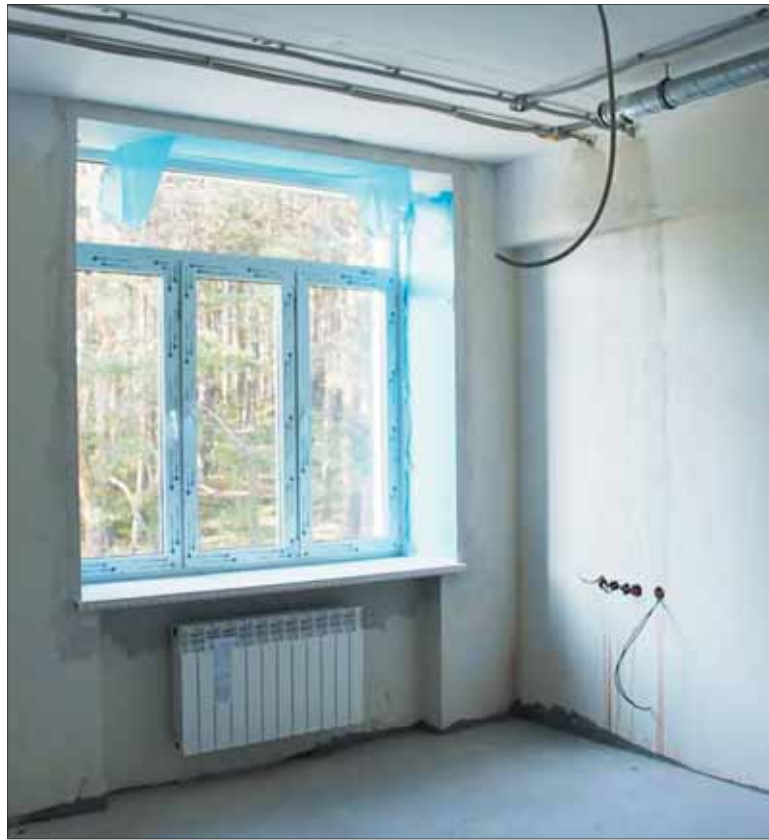
Работы ведут одновременно на трех этажах до 30 человек. Пыльная часть выполнена: сделана перепланировка, заменены окна / ФОТО ПРЕСС-СЛУЖБЫ АДМИНИСТРАЦИИ НТГО
