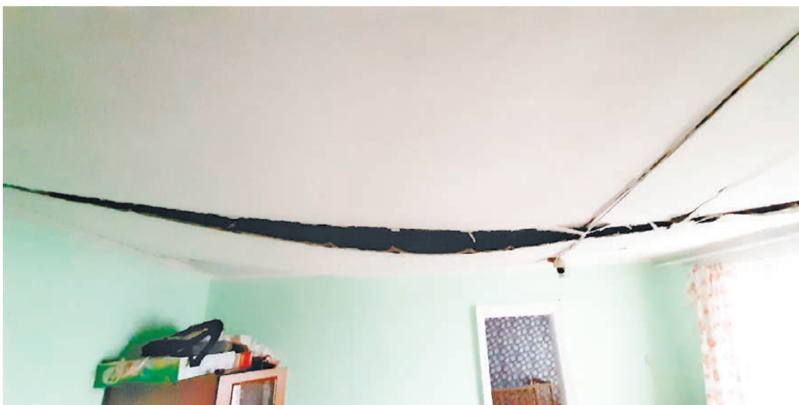
Комната в квартире №7, в которой обрушился потолок
