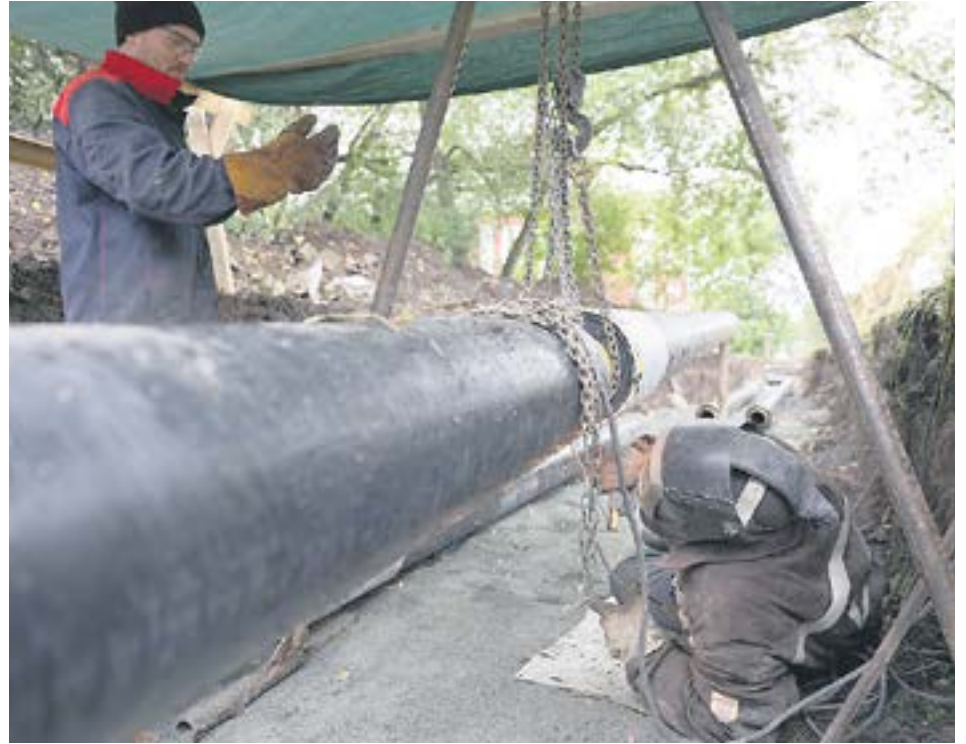
Вот так варят трубы подрядчики компании ЕТК. Специалисты говорят, что залог успеха — качественные японские электроды и умелые руки сварщиков. Повозиться со стыками здесь пришлось. Зато швы получились с идеальным наплывом. // Фото Владимира Коцюбы-Белых
