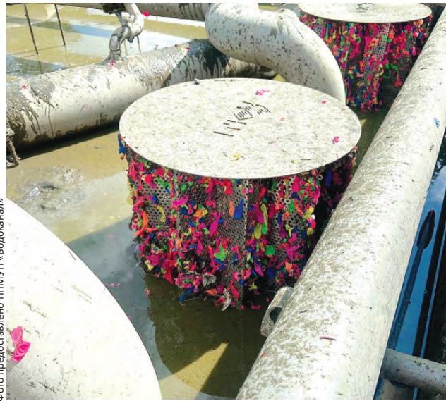
Фото предоставлено ППМУП «Водоканал»
