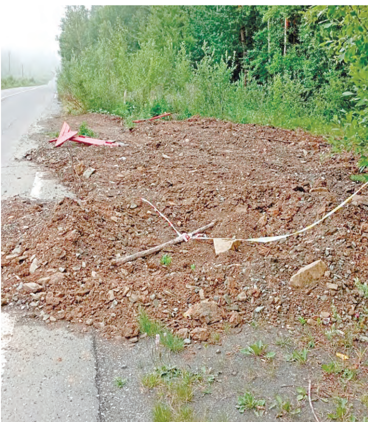
Водовод рвётся всё чаще
