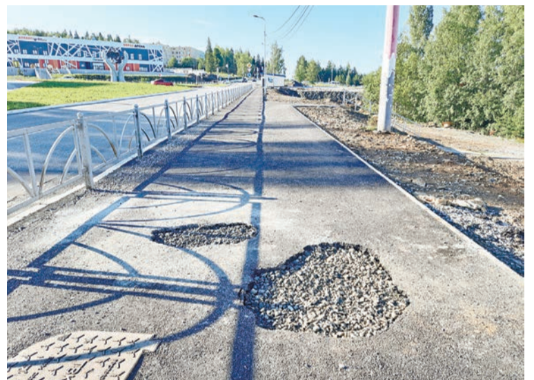
Новый асфальт на тротуаре не простоял и недели, как был вскрыт
