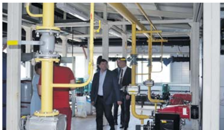
Новая котельная в посёлке Зырянском
