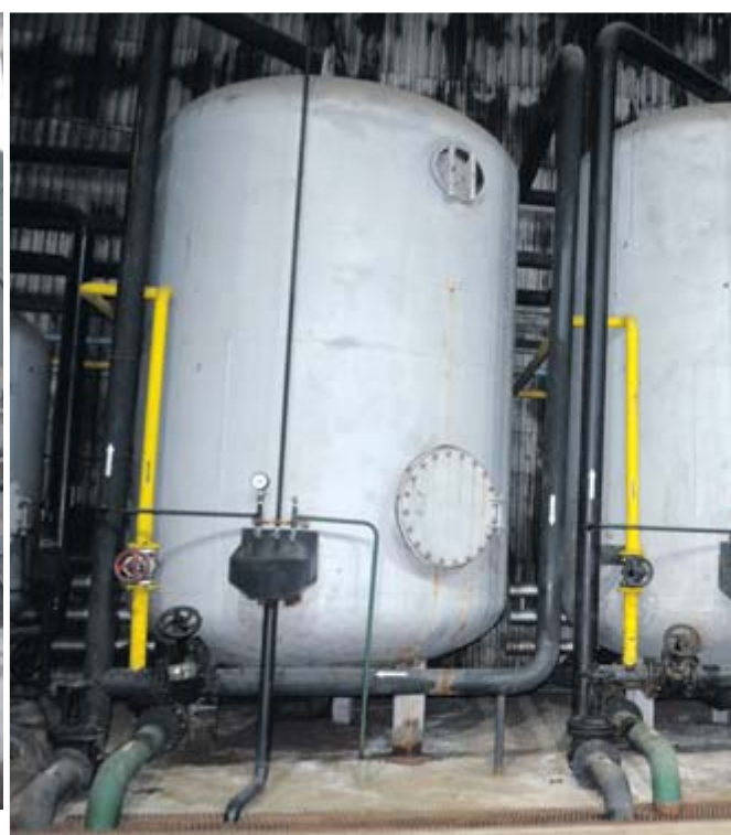
Химводоочистка ООО «АТЭК»
