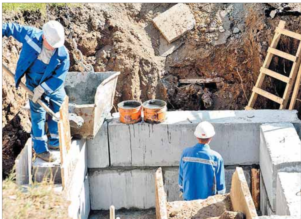
] На этом участке уложат стальные бесшовные трубы в пенополиуретановой изоляции с системой оперативного дистанционного контроля / ФОТО СЕРГЕЯ ЧИКИШЕВА
