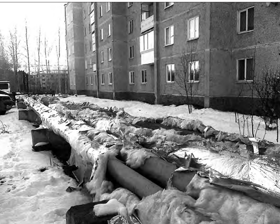
Теплотрасса у дома №2 по улице Сенной.
