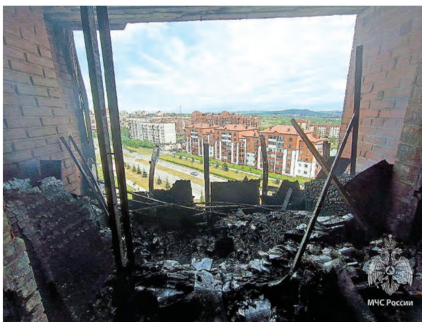
Последствие пожара на балконе одной из квартир Ленина, 130.
