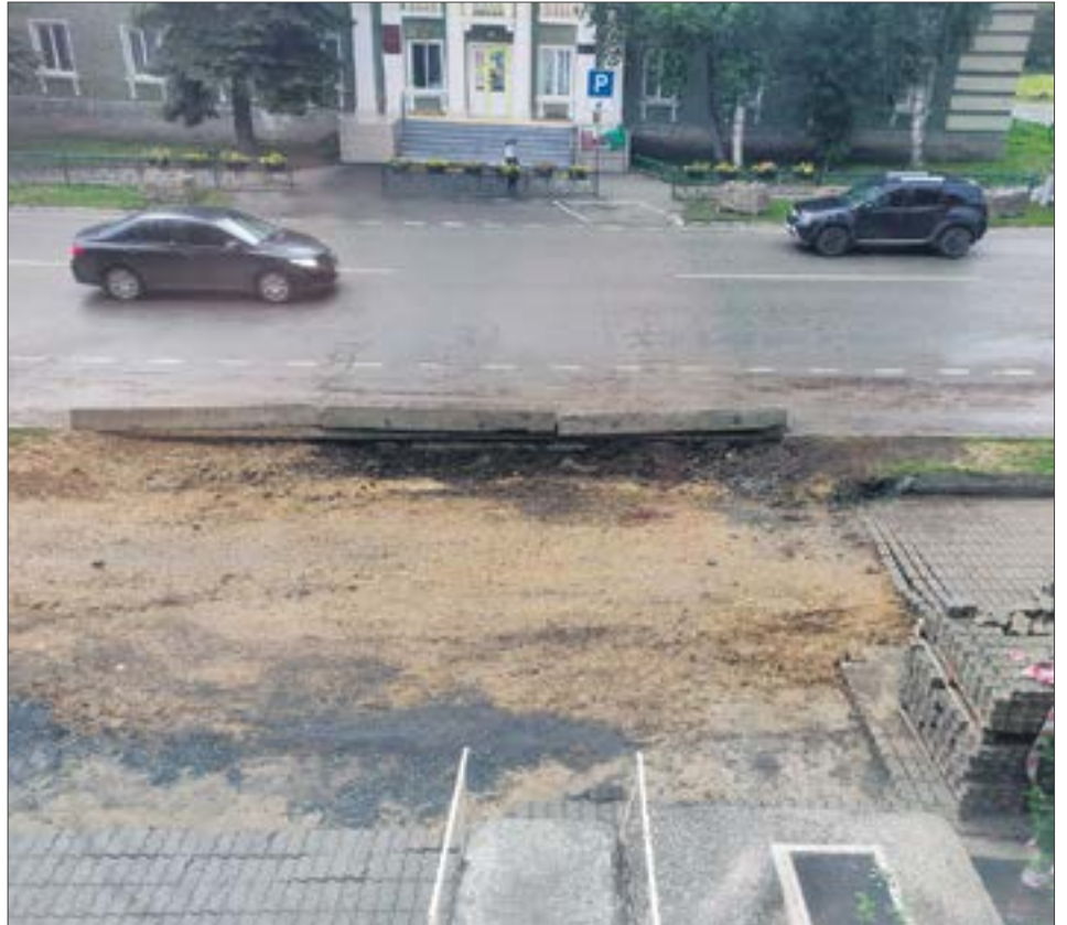
Одна из самых свежих раскопок «Водоканала» — прямо на входе в администрацию города. Есть информация, что предприятие восстановит здесь благоустройство в конце лета, но это не точно. // Фото Олега Клочкова
