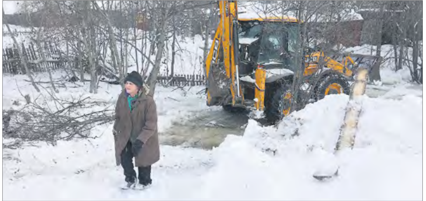
В Каменушку в районе улицы Циолковского удалось загнать технику, которая вскрыла русло. Местные жители тоже помогли коммунальщикам. Фото Владимира Коцюбы-Белых
