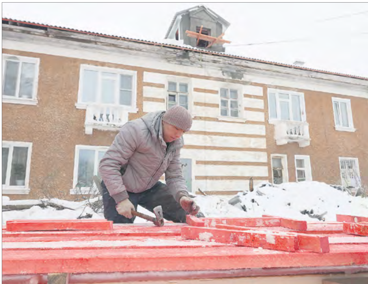
На ул. Карла Либкнехта, 45 завершается капитальный ремонт — здесь осталось привести в порядок слуховое окно и утеплить чердак. При этом фасад дома находится в удручающем состоянии, но на его ремонт нет денег. // Фото Владимира Коцюбы-Белых
