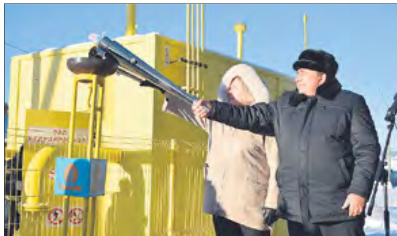
Торжественный запуск газопровода на Биатлоне состоялся 28 декабря прошлого года. В церемонии приняли участие министр энергетики и ЖКХ Свердловской области Николай Смирнов и глава города Татьяна Клепикова. Фото из паблика администрации в ВК.
