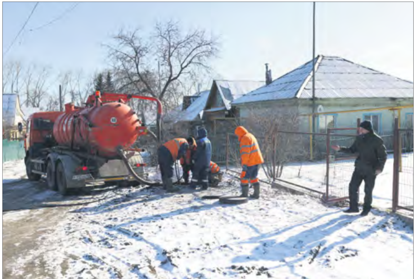
Как выяснилось, причиной потопа на улице Урицкого стало повреждение частного водовода — там был сломан кран, который специалисты «Водоканала» успешно заменили. // Фото Владимира Коцюбы-Белых
