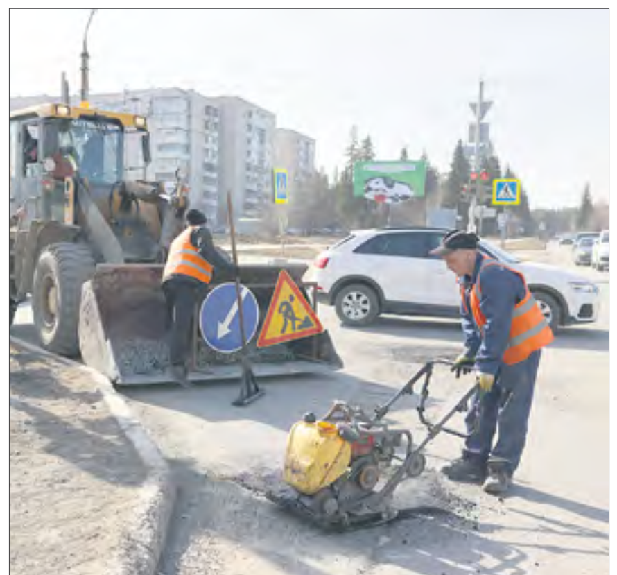
В Ревде стартовал ямочный ремонт. «Армада» начала латать самые опасные ямки на проезжей части холодным асфальтом. Эта мера позволит дожить дорожному полотну до полноценного ямочного ремонта и сделать передвижение на таких участках относительно безопасным. // Фото Владимира Коцюбы-Белых
