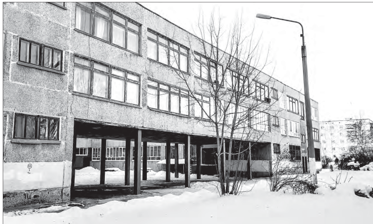
Одна из самых холодных частей здания школы – та, что установлена на сваях и начинается со второго этажа. Расположенные в ней классы выхолаживаются сильнее остальных
