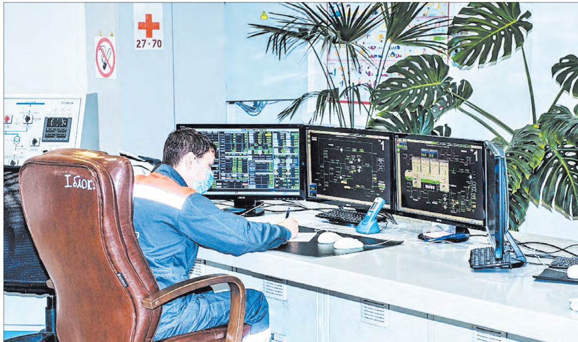
«Мозг» НТГРЭС – щит управления, где круглосуточно осуществляется оперативное управление основным и вспомогательным оборудованием. На мониторы выведены параметры по двум блокам парогазовой установки / ФОТО СЕРГЕЯ ЧИКИШЕВА
