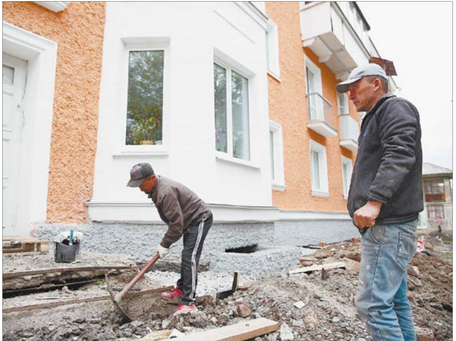
На Чехова, 9 капремонт систем водоснабжения и водоотведения уже завершён, осталось привести в порядке только электроснабжение и отопление, а еще доделать крышу, фасад и подвал. // Фото Владимира Коцюбы-Белых
