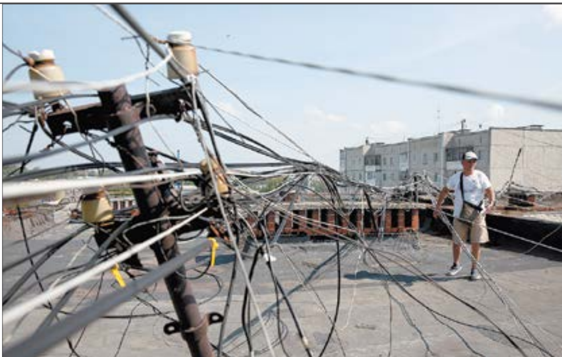
На этой неделе начался капремонт крыши дома №1 на улице Ковельской. Здесь мало того, что огромная куча непонятно чьих проводов, они заходят в дом через карниз, который сегодня уже частично разрушен. В этом доме вообще нет входа для проводов, прокладка кабель-каналов не вошла в техническое задание капремонта. // Фото Владимира Коцюбы-Белых.
