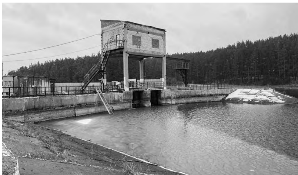
Ремонт гидротехнического сооружения Ургинского пруда. В этом году освоено 11 миллионов рублей. В 2023-м работы продолжатся.
