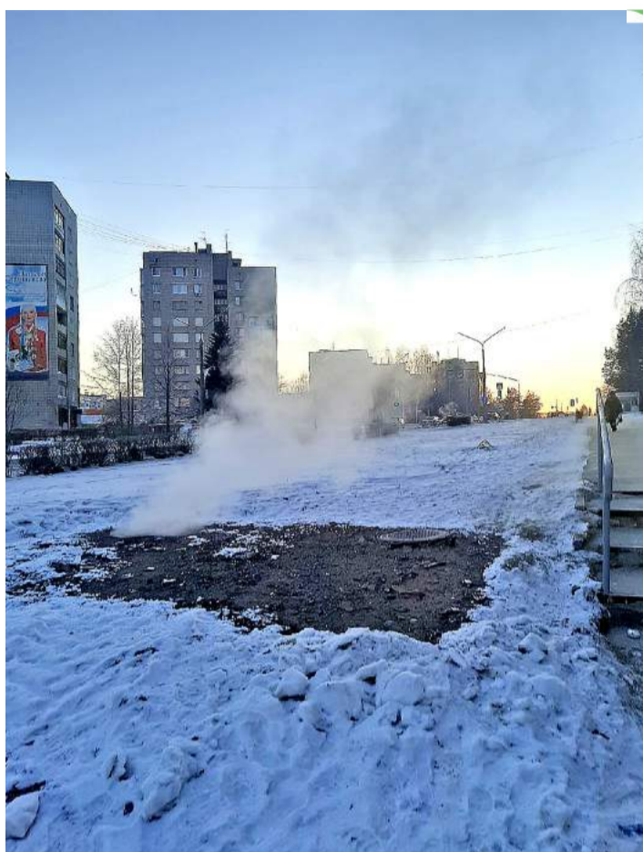
Парение теплокамеры в районе дома № 66 по улице Ленина.
