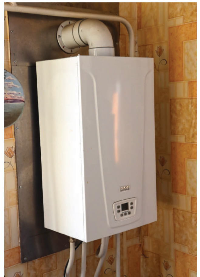
Необходимые характеристики газового оборудования прописываются в проектной документации, в том числе и на котёл.
