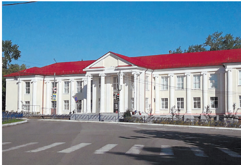
Масштабные работы идут в Центре культуры и искусств: ремонтируется центральный фасад, который вскоре украсит архитектурная подсветка.
